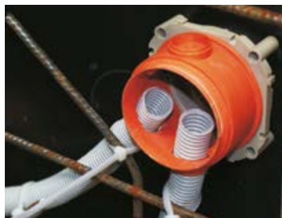
Корпус KBV и подведенные в него трубы.
